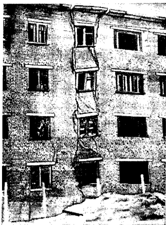
Рис. 17.1. Деформации здания вследствие неравномерной осадки при оттаивании многолетнемерзлого грунта основания, г. Воркута (фото Е. М. Чувиллина)
