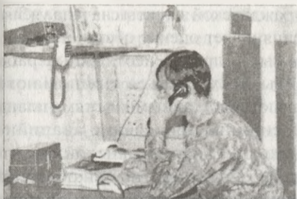
Рис. 22. Помещение пункта управления
