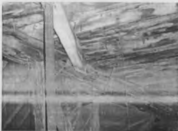
Рис. 6.26. Поражение грибом деревянных стропил школы. Установлена временная стальная подпорка.
