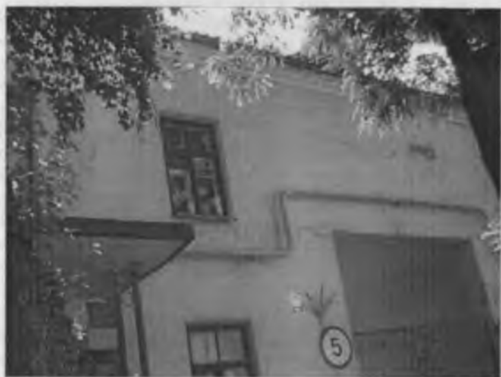
Рис. 3.11. Трещины в наружных стенах административного здания в результате замачивания и проседания грунтов основания по главному фасаду.
