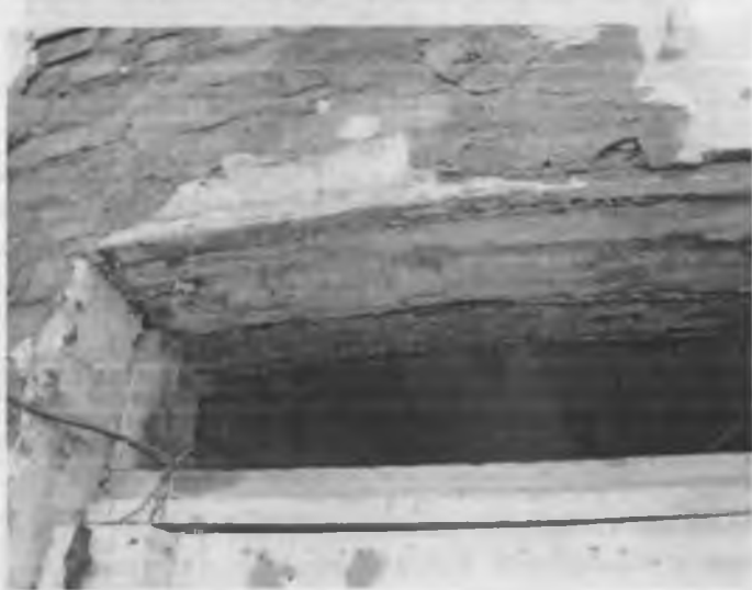
Рис. 8.16. Обрушение участков штукатурного слоя.
