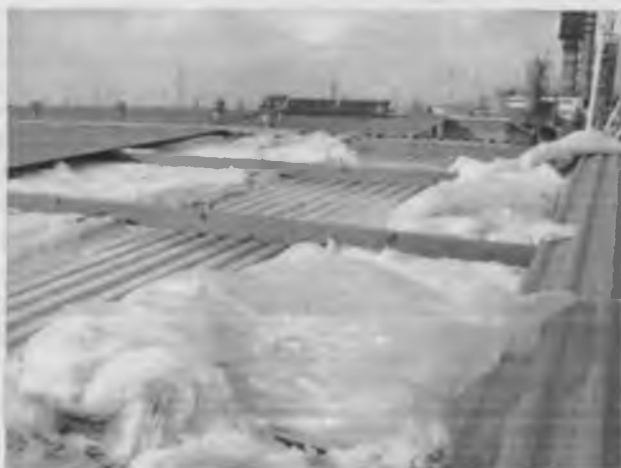
Рис. 6.38. Разрушение кровли над административным зданием после ураганного ветра (причина разрушения – неудовлетворительное крепление обрешётки к прогонам).
