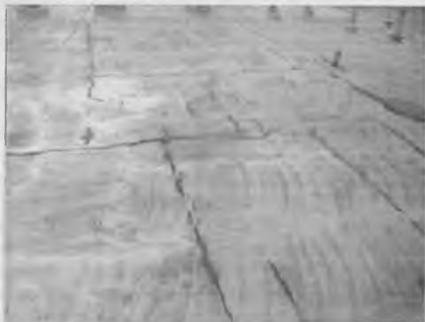
Рис. 6.37. Разрушение совмещенного кровельного покрытия вследствие нарушения технологии производства работ при устройстве выравнивающей стяжки.
