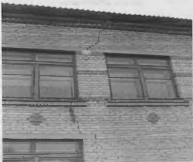
Рис. 3.10. Образование и рост трещины стены здания.
