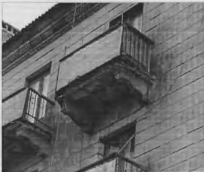
Рис. 6.31. Разрушение бетона консоли и балконной плиты жилого дома.
