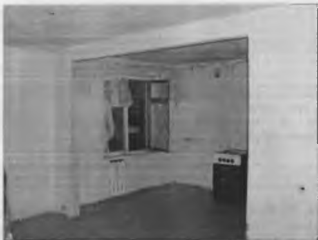
Рис. 3.12. Самовольная перепланировка квартиры на 3-ем этаже 9-этажного жилого дома. Без предварительного усиления вырезана значительная часть поперечной несущей стеновой панели, разделяющей кухню и жилую комнату.
