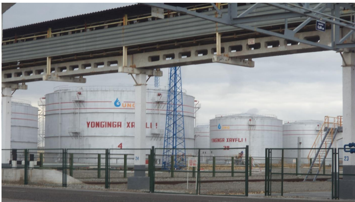
16.11-rasm. Buxoro neftni qayta ishlash zavodi er usti muhandislik tarmoqlarini ko‘taruvchi metall va temirbeton konstruksiyalar
