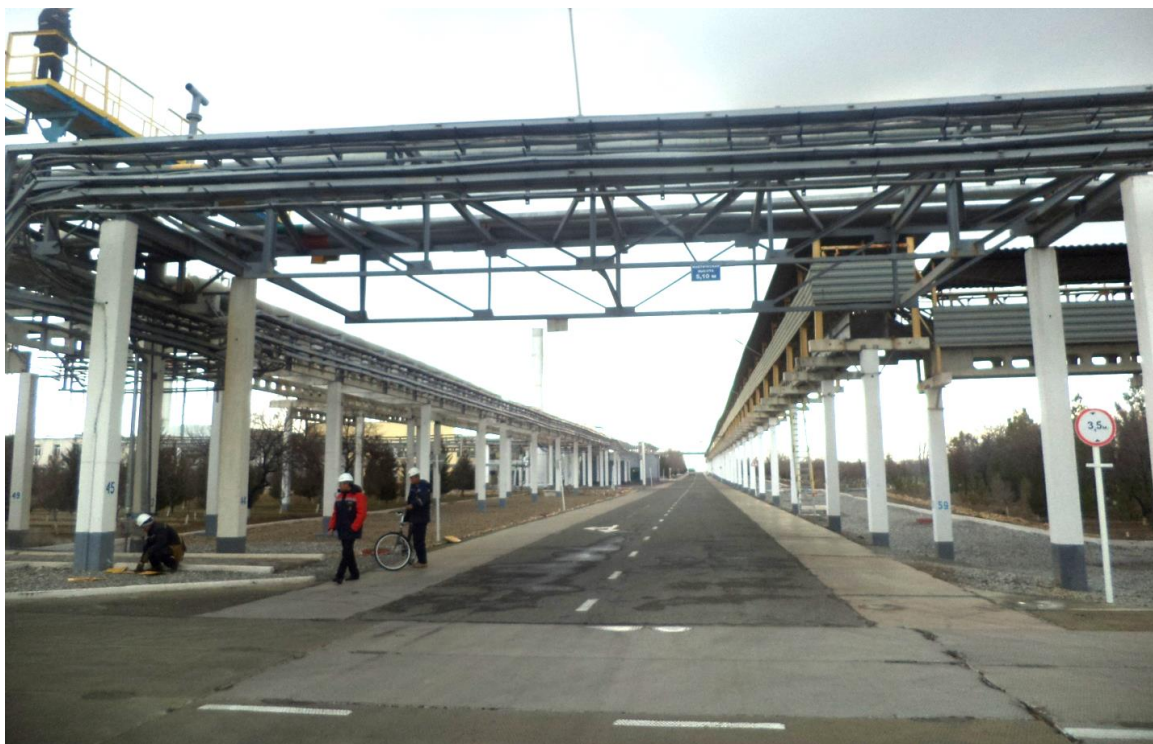
16.10-rasm. Buxoro neftni qayta ishlash zavodi er usti muhandislik tarmoqlarini ko‘taruvchi metall va temirbeton konstruksiyalar
