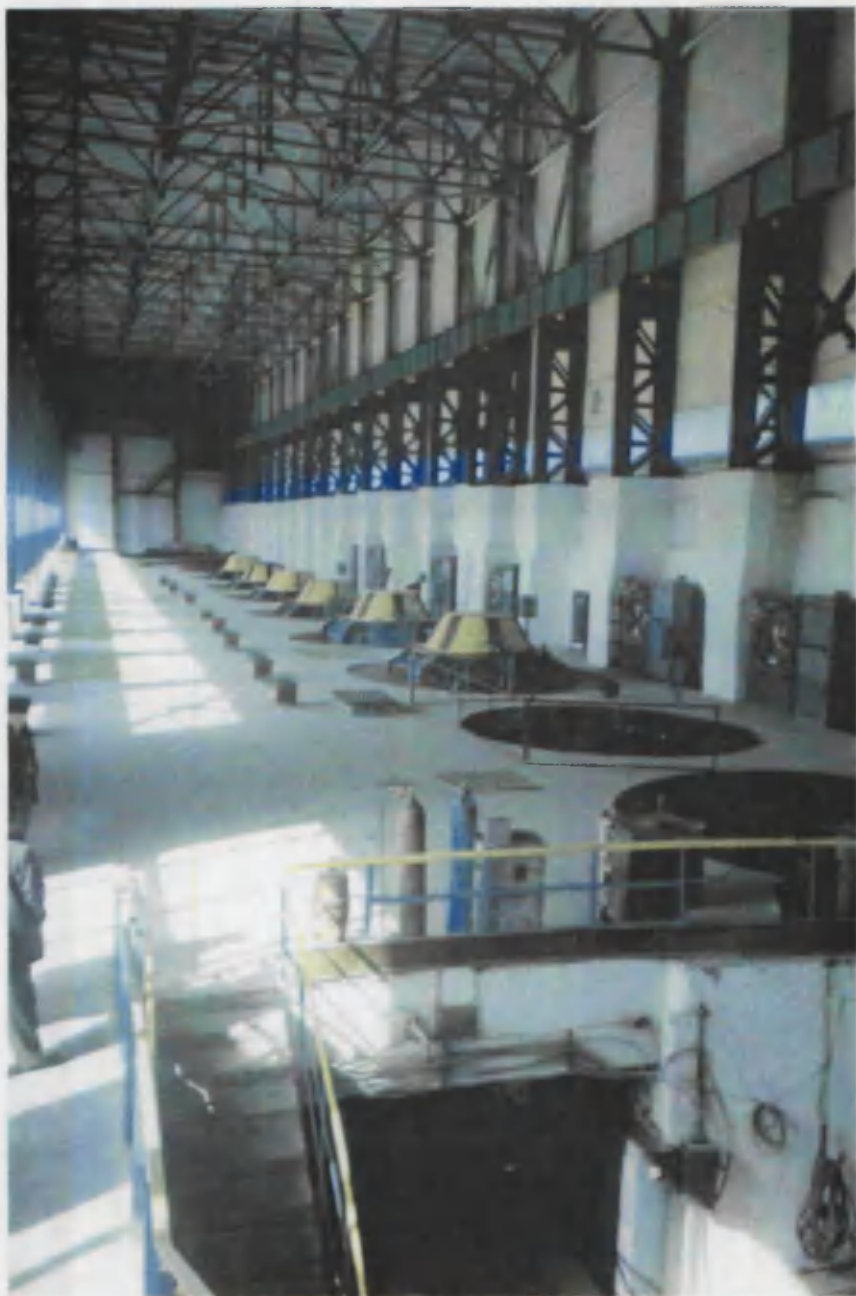
Жиззах насос станцияси - бунёдкорлик иншооти.
