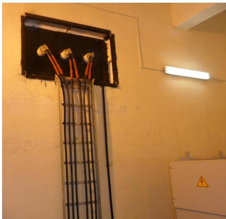
18.4 - rasm. Nasos stansiyasining tarqatish qurilmasiga kabel liniyalarning vertikal holatda kirishi
