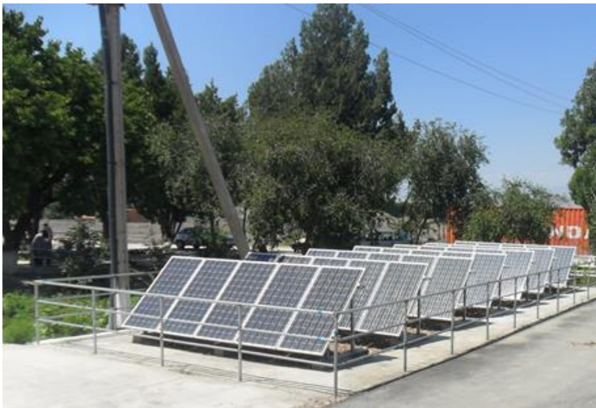
6.1 – rasm. «Dangara» nasos stansiyasidagi quyosh fotoelektrik qurilmalari paneli
