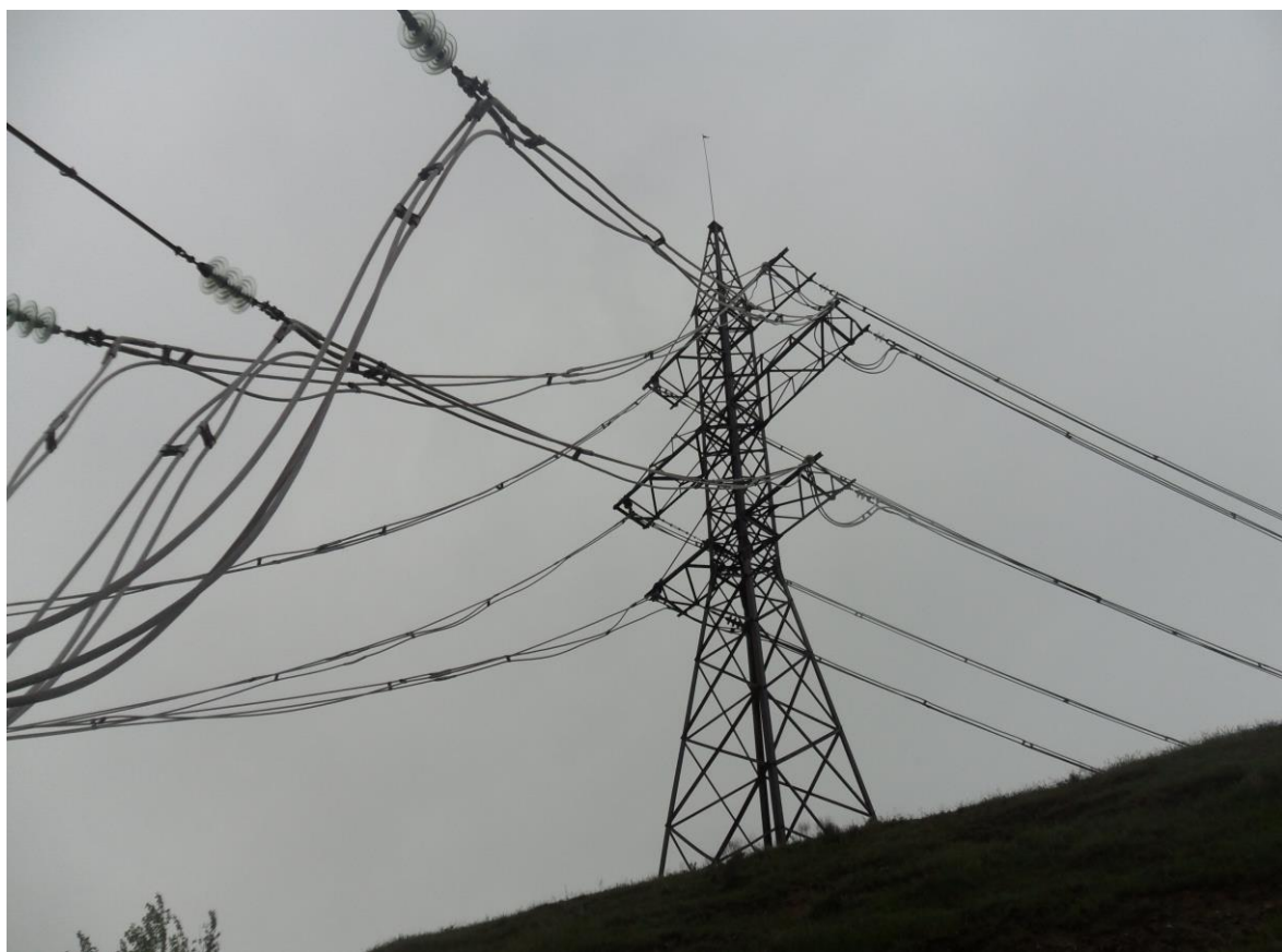
1.3 - rasm. A 300 elektr o'tkazichidan qurilgan kuchlanishi 35 kV li elektr ta'minot tarmog'i
