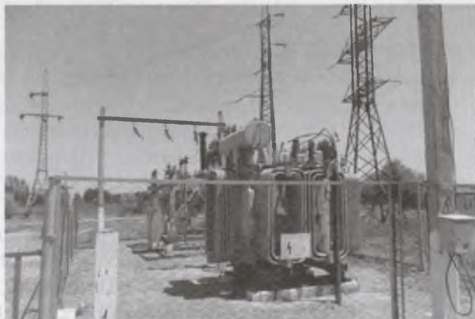
9.3-rasm. Kuchlanishi 35/6,0 kVli transformator podstansiyasi va uning elektr tarmoqlari.
