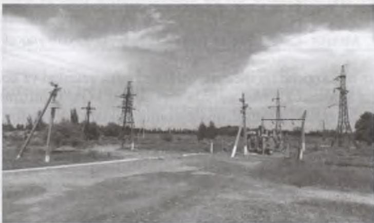
14.1-rasm. Kuchlanishi 35 va 10 kV li havo elektr liniyalarining podstansiyaga kirishi va chiqishi.
