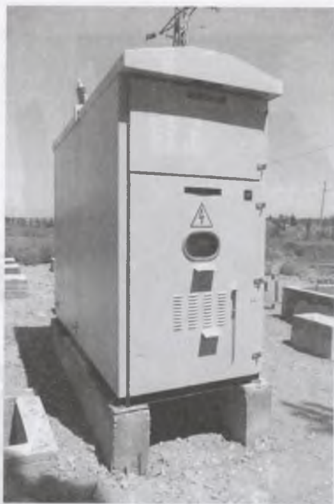
Kuchlanishi 35/04 kV li quvvati 100 kVA li transformator.
