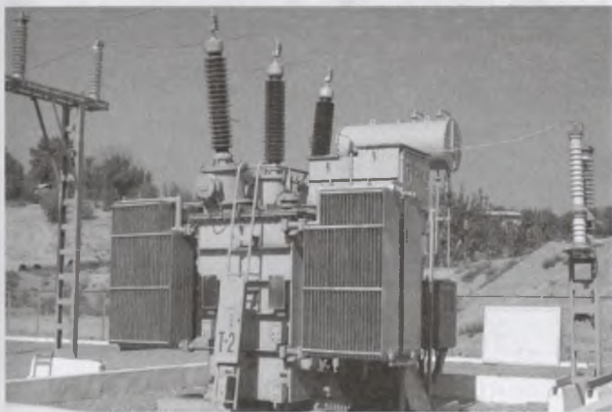
1.1-rasm. Kuchlanishi 110/10 kV li quvvati 16 000 KV li moy transformatorli podstansiya.
