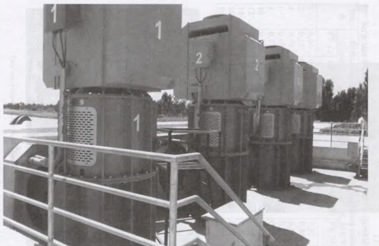
Farg'ona viloyatidagi «Furqat» nomli nasos stansiyasidagi kuchlanishi 6 kV li vertikal holda o'rnatilgan elektronasos agregatlari
