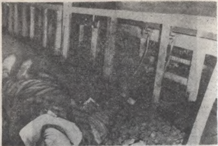
Рис. 5.4. Тело пострадавшей на месте происшествия после соприкосновения с шинами постоянного тока напряжением 157 В Вид со стороны входа в распределительное устройство
