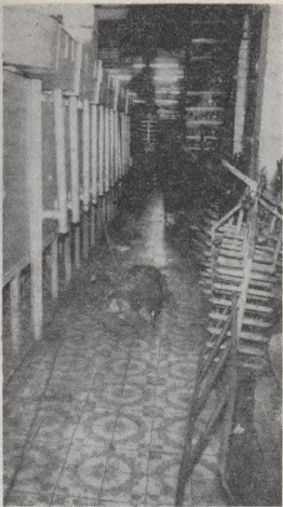
Рис. 5.3. Помещение распределительного устройства, где произошла электротравма
