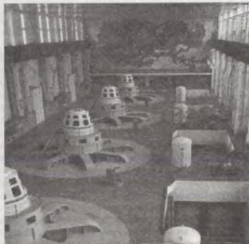
Рис. 2.5. Машинный зал Чарвакской ГЭС
