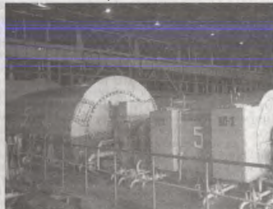
Рис. 2.9. Турбоагрегат марки К-300-240 на станции Ново-Ангренской ТЭС
