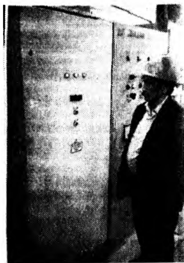
15.1-rasm. Nasos agregatining asinxron elektr yuritmasini boshqarish uchun 200 kVt quvvatli elektr tejamkor qurilmaning umumiy ko'rinishi
