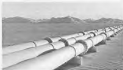
17.1-rasm. Magistral gaz quvurining umumiy ko'rinishi
