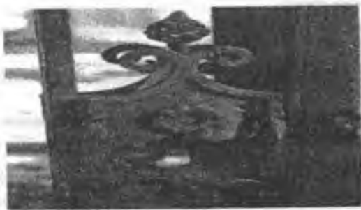
8-rasm. Korroziyaga uchragan panjara.
