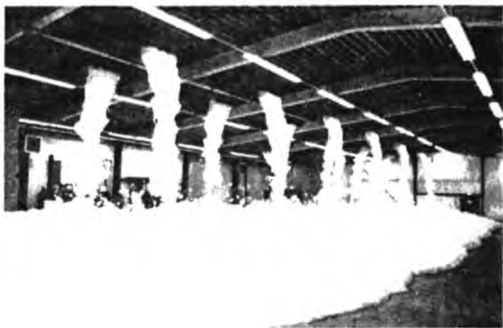
Рис. 19. Тестовые испытания спринклерной установки
