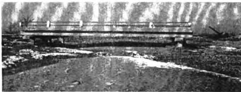
Рис. 2.22. Фотография разрушенного моста
