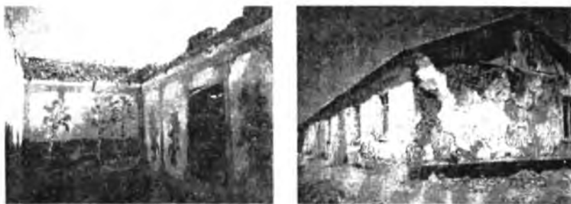
Рис. 2.8. Фотографии повреждений при Камашинском землетрясении 2000 г.
