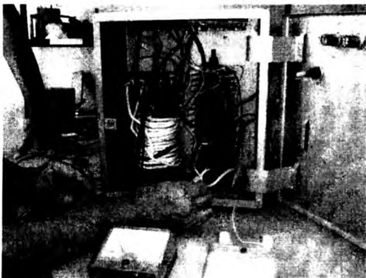
Рис. 5.1. Внутренний вид понижающего трансформатора с 220 В до 12 В, сила тока 50 А.
